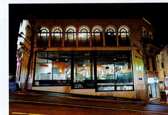
En haut, avant rénovation. Après rénovation (photo du bas), les grandes vitrines ouvrent le bâtiment sur l'avenue. Presque toute la façade est vitrée une fois enlevé les bandeaux noirs qui occultaient le haut des vitrines.
